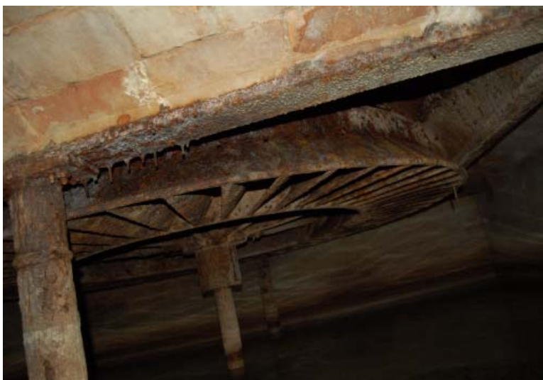
Vista de la turbina con su eje inferior y los soportes de la obra
