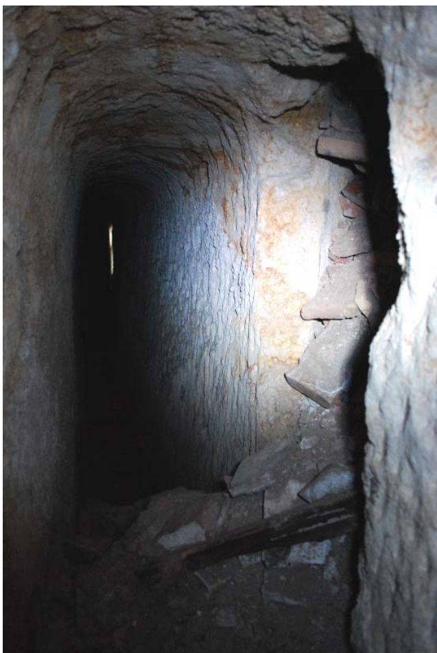
Acolmatamiento de escombros
