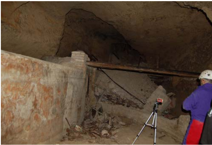
A la izquierda la presa, al fondo el contacto con las dependencias superiores, colapsado, y a la derecha la rejilla de entrada de agua a la turbina.
