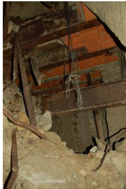
Estado ruinoso del recinto superior
