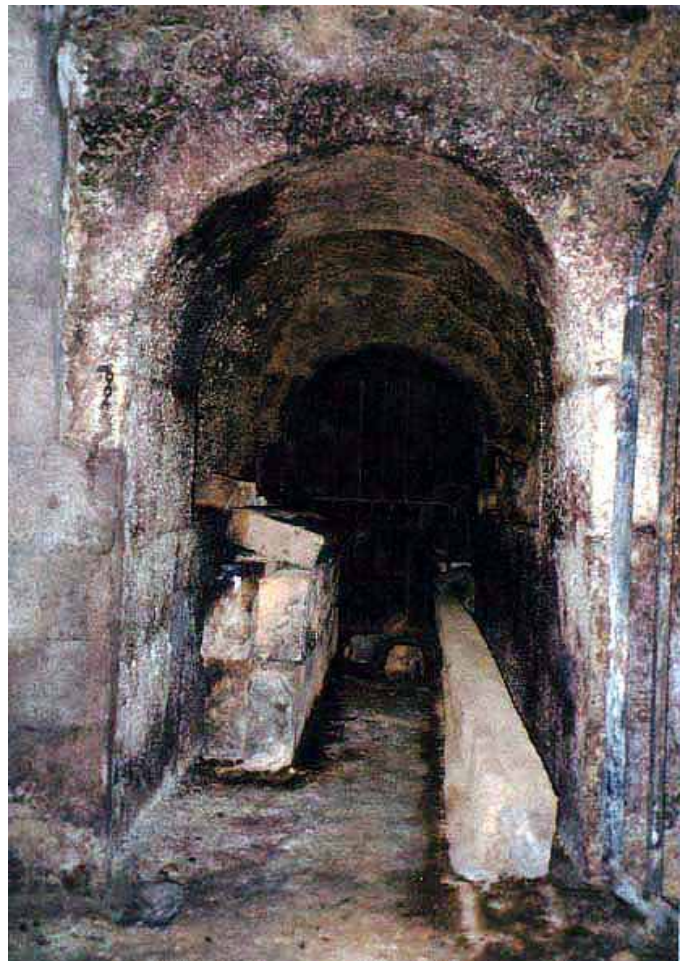
Manzana 15.- C/ Santa Engracia, nº 58 (M 15-0). Pasadizo con refuerzos en sillería entre calados.
